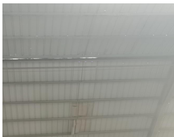
图 16 原料库喷淋装置
