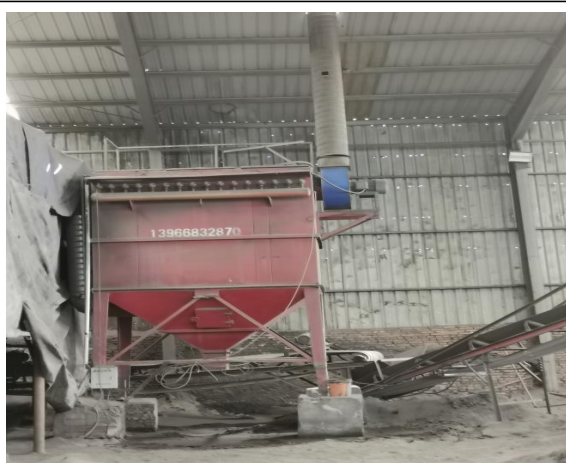
图 15 袋式除尘器+DA002 排气筒
