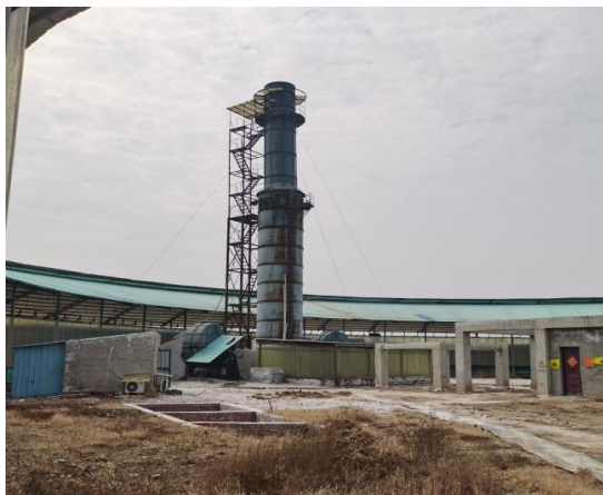
图 13 脱硫塔 DA001 及配套多级沉淀池
