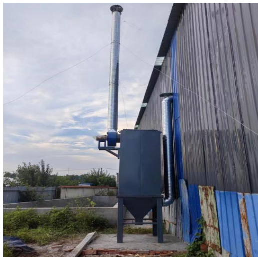
图 8 袋式除尘器+DA003 排气筒
